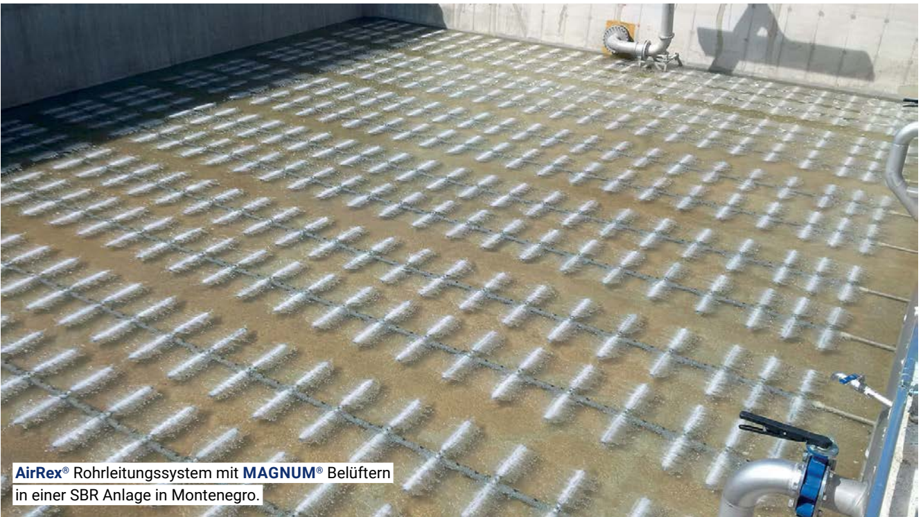
AirRex® Rohrleitungssystem mit MAGNUM® Belüftern in einem Rundbecken in Norddeutschland.
